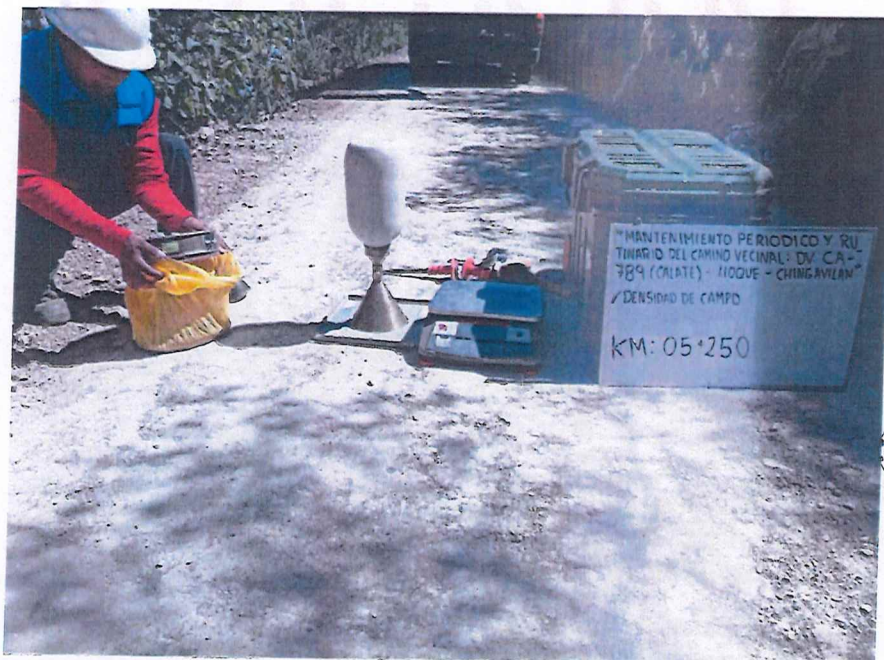
FIGURA N° 22. Ensayo de Densidad de Suelo en Campo. Progresiva 05 + 250 (Método del cono de arena).
