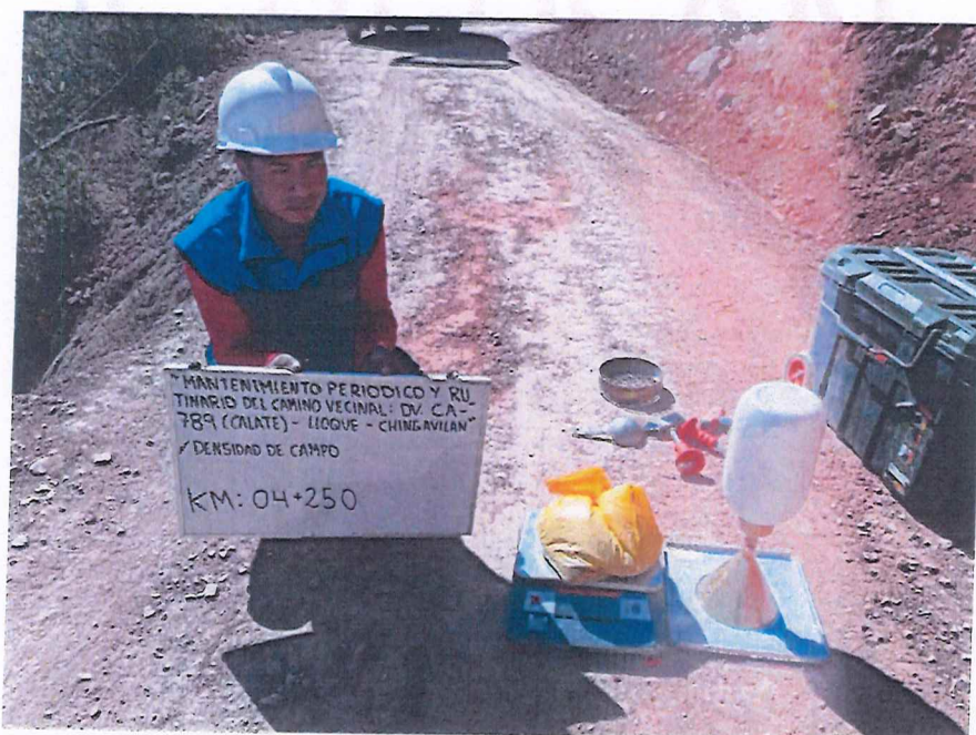
FIGURA N° 18. Ensayo de Densidad de Suelo en Campo. Progresiva 04 + 250 (Método del cono de arena).
