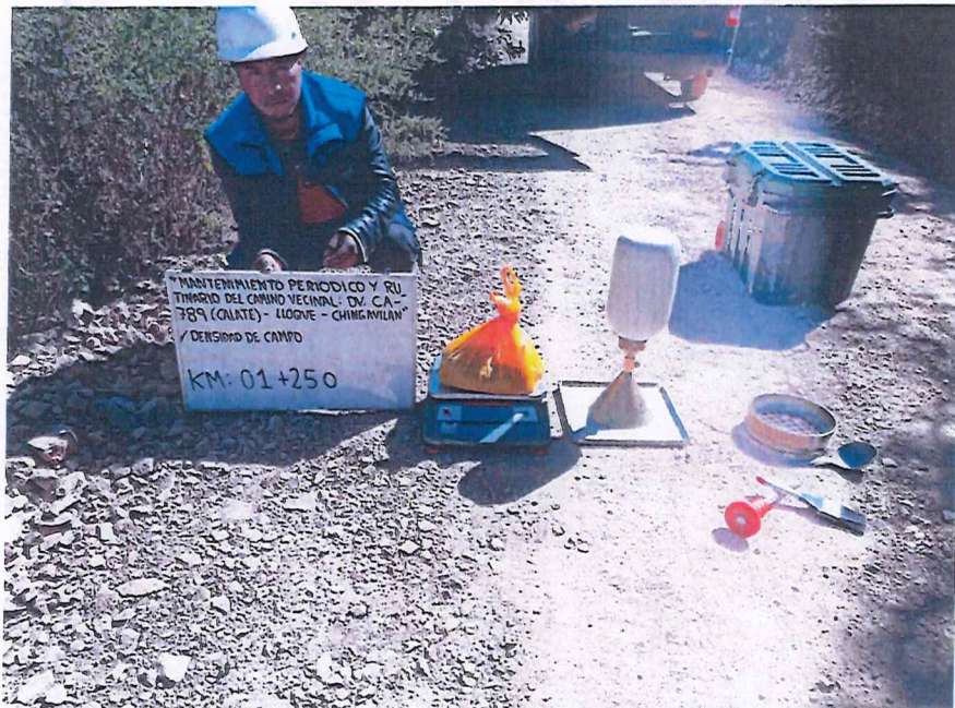
FIGURA N° 6. Ensayo de Densidad de Suelo en Campo. Progresiva 01 + 250 (Método del cono de arena).
