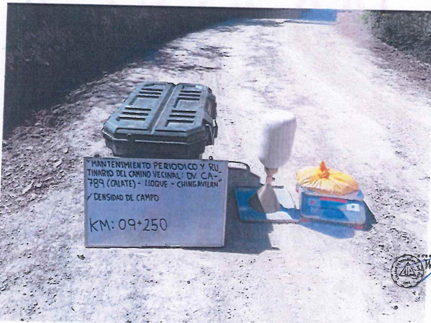
FIGURA N° 38. Ensayo de Densidad de Suelo en Campo. Progresiva 09 + 250 (Método del cono de arena).
