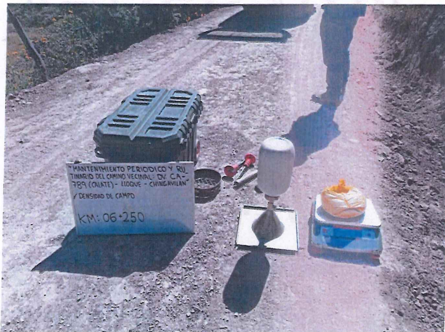
FIGURA Nº 26. Ensayo de Densidad de Suelo en Campo. Progresiva 06 + 250 (Método del cono de arena).
