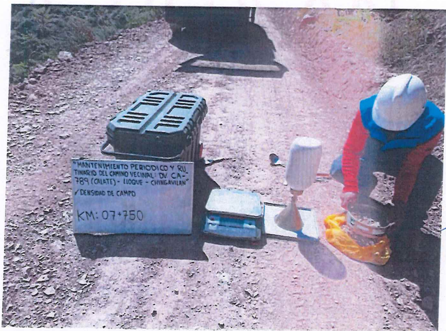
FIGURA N° 32. Ensayo de Densidad de Suelo en Campo. Progresiva 07 + 750 (Método del cono de arena).
