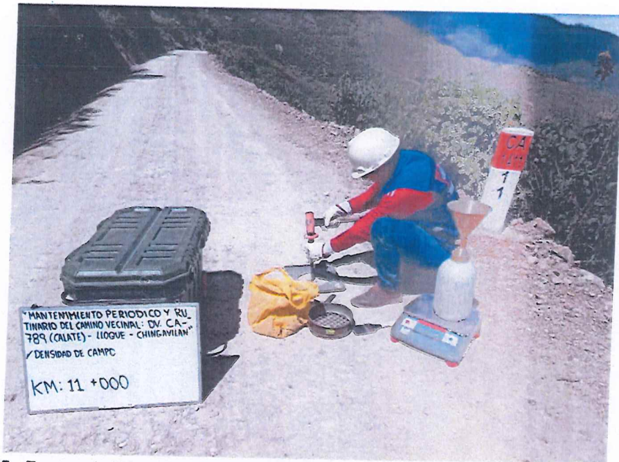
FIGURA N° 45. Ensayo de Densidad de Suelo en Campo. Progresiva 11 + 000 (Método del cono de arena).
