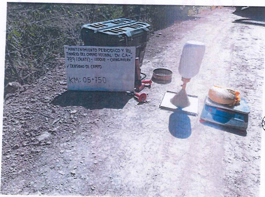
FIGURA N° 24. Ensayo de Densidad de Suelo en Campo. Progresiva 05 + 750 (Método del cono de arena).
