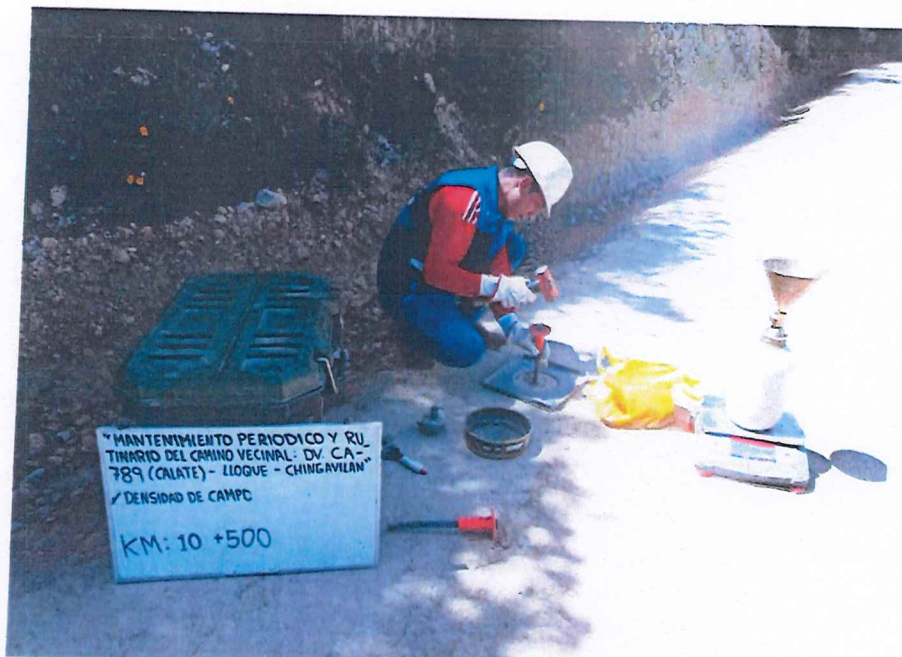
FIGURA N° 43. Ensayo de Densidad de Suelo en Campo. Progresiva 10 + 500 (Método del cono de arena).
